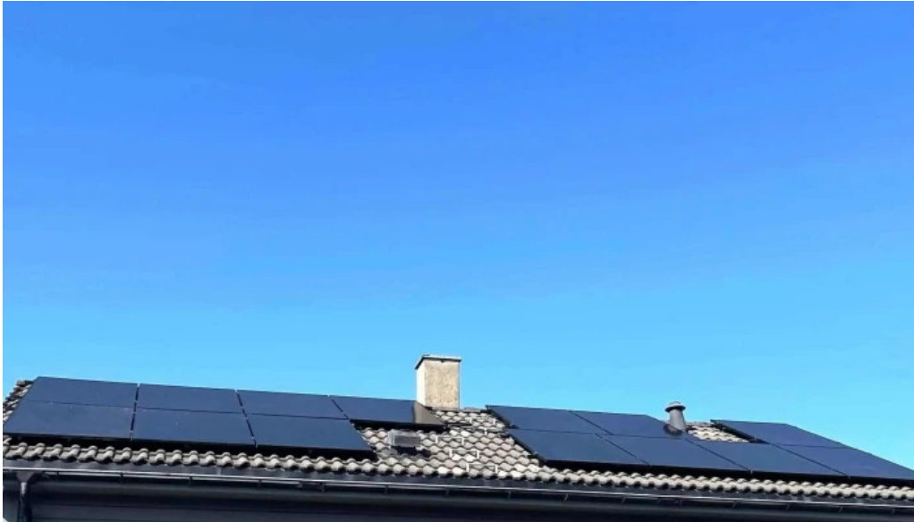
Insol as leverandør av solenergiutstyr
