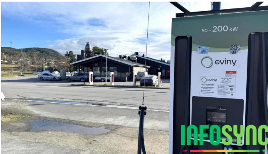
Eviny ladestasjon alle
