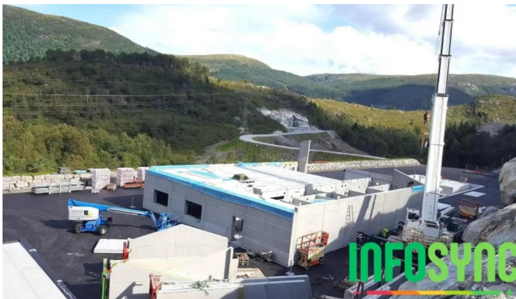
Arna omformerstasjon indre arna
