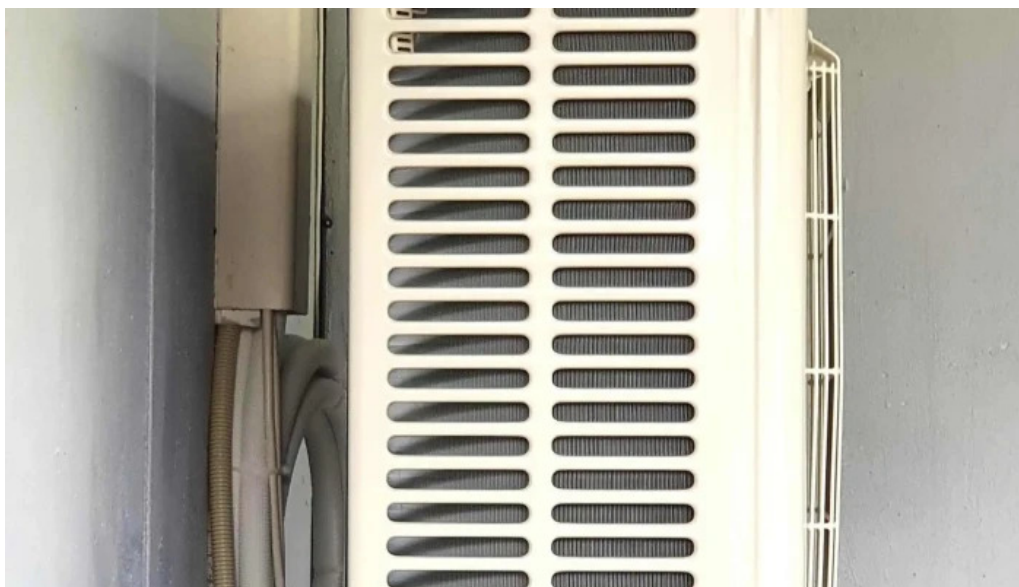
Midt elektro plassering
