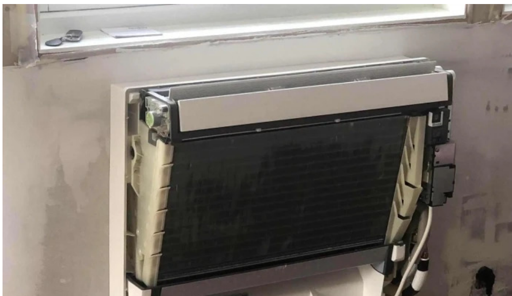
Innovasjon elektro as elektriker
